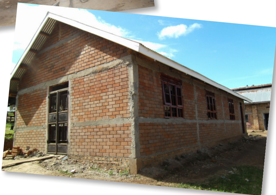
Die Baustelle der Hauswirtschaftsschule im Mai 2014. Der Betrieb soll in den nächsten Monaten aufgenommen werden.
